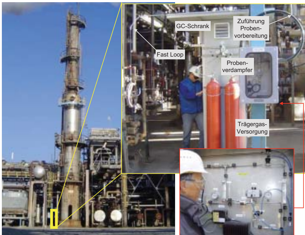
Bild 3: GC-Analysenschrank mit Probenverdampfung und -vorbereitung unmittelbar neben einer LPG-Kolonne.
