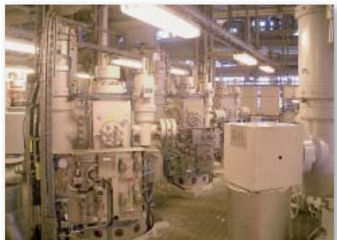
Emersons Rosemount Smart Wireless Druck-Messumformer zeigten sich selbst in der metallbefrachteten Umgebung des Brunnenkopfes der Grane-Plattform als äußerst zuverlässig. (Bild: StatoilHydro)
