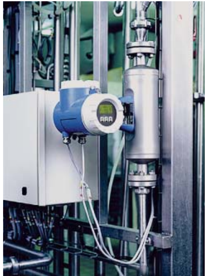
Bild 8: Coriolis Massemesser (Promass I) im Einsatz.
