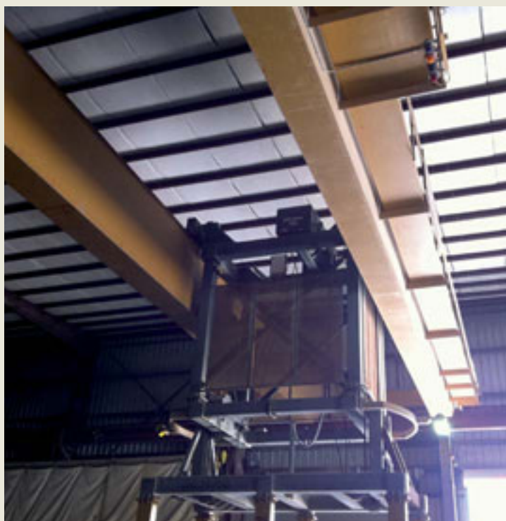
BILD 1: Brückenkran nach der Modernisierung
