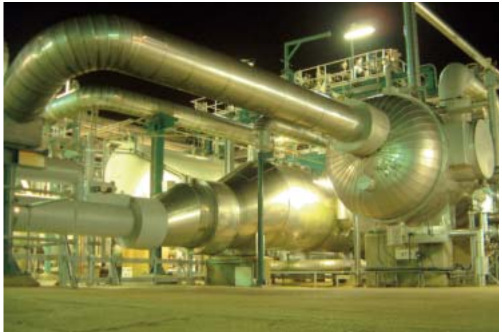
In der Prozessindustrie zählen Sicherheit und Verfügbarkeit – ein modernes Sicherheitssystem muss sich diesen Anforderungen stellen.
